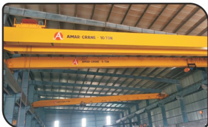
EOT CRANE (07 Nos)
